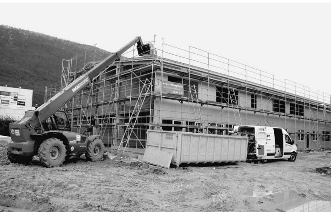
Nach der Kontrolle ist vor der Kontrolle: Dass das Isoliermaterial, das aufs Dach gehievt wird, durchnässt ist, scheint den Vorarbeiter wenig zu kümmern.
